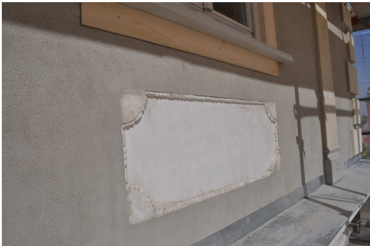
Abb. 4: Vorzustand-Ostseite, 1.OG eingelassene Brüstungsplatten
