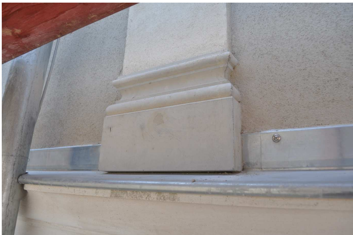
Abb. 8: Vorzustand Ostseite, 1.OG neu gegessene Basis aus mineralischer Gussmasse
