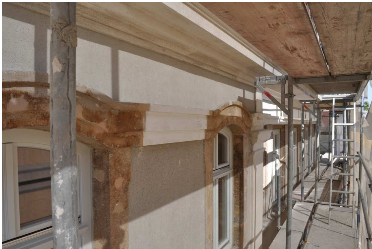
Abb. 3: Vorzustand-Ostseite, EG glatte Stuckelemente an Werkstein
