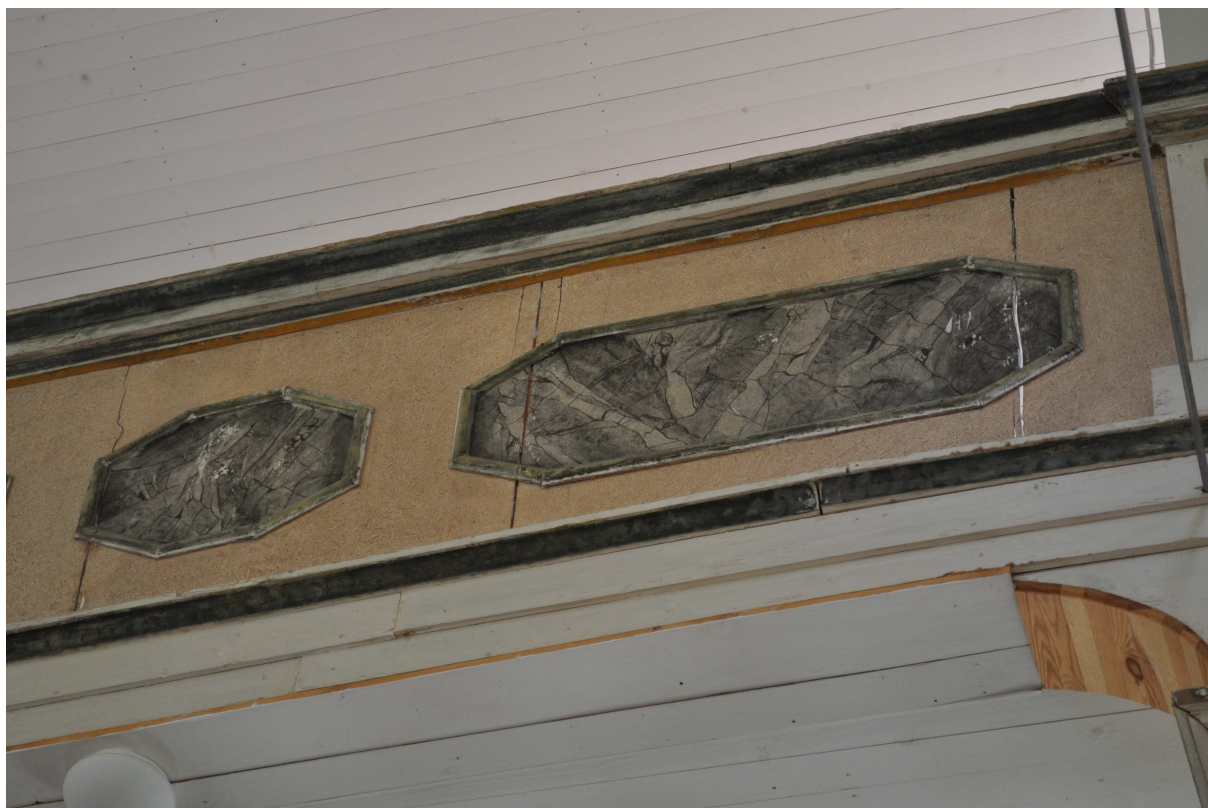
Abb. 9: Vorzustand Detail obere Brüstung
